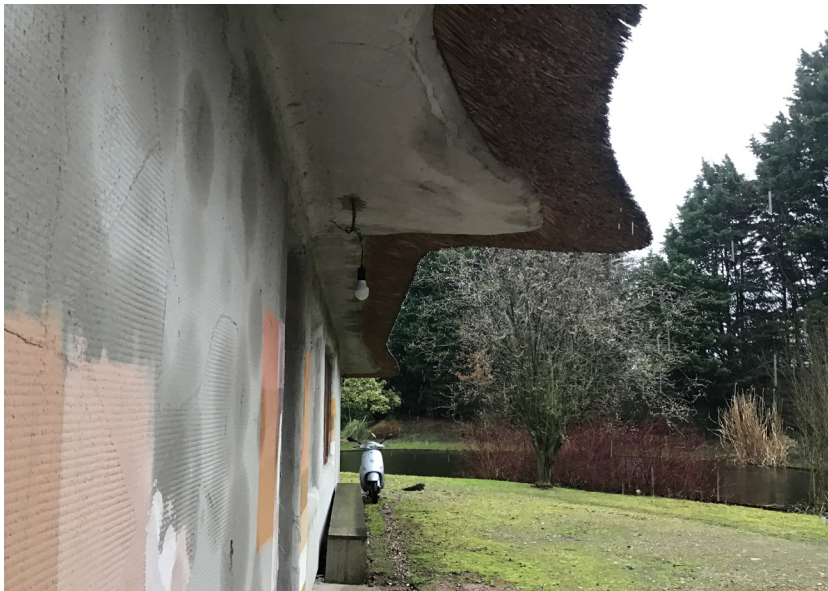
Fig.17: Wand A: dakoversteek
