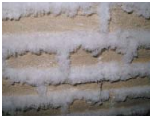
Figuur 3: Zoutuitbloei op in goede staat verkerend 19de eeuws kalkvoegwerk. Door de open structuur van de kalkmortel kunnen vocht en zouten vrij naar buiten treden zonder dat daarbij schade ontstaat. [15]
