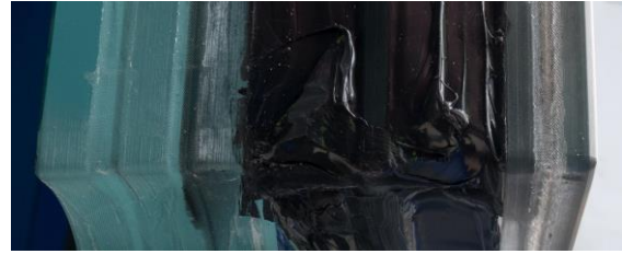
Afb. 6.35: De afdichtingsvoeg van de spouwen van een IGU werd overvloedig aangebracht. (© Lüchinger Meyer)
