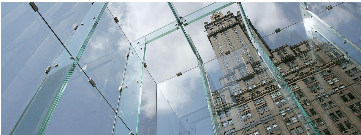
Afb. 6.4: De gevelpanelen zijn langs de lange zijden bevestigd aan tien meter hoge glazen vinnen. (© sedak.com. Uit [4])
