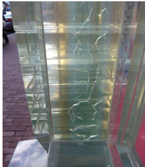
Afb. 1.17: Scheuren in de lijm waarmee de raamkaders in de glaswand werden bevestigd.
