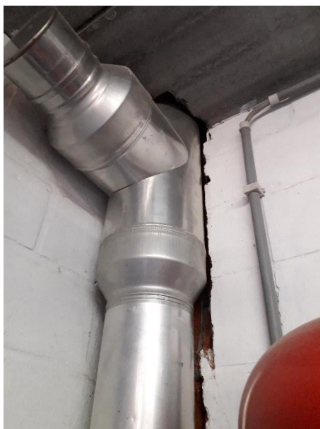
Figuur 27: luchtlek garage - W1
