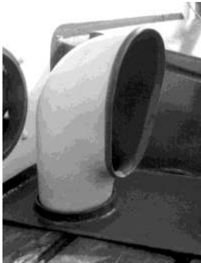
Afb. 48 Deze luchtopening voert kwalijke dampen uit de machinekamer af.
