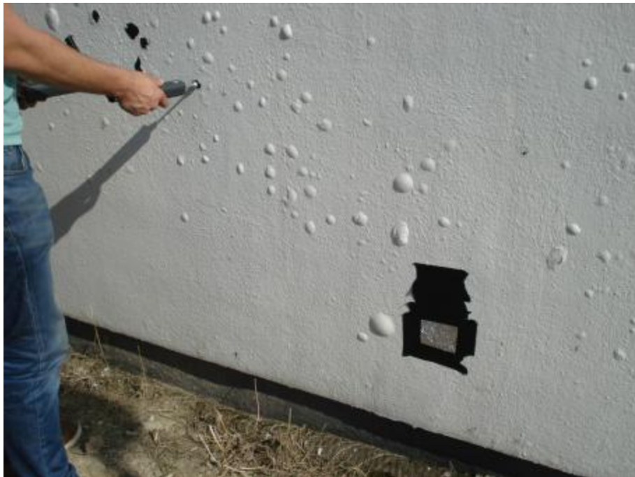
Figuur 31: Blaasvorming op de gevel
