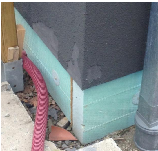
Figuur 153: Losgekomen stukken pleister onderaan de muur in de hoeken
