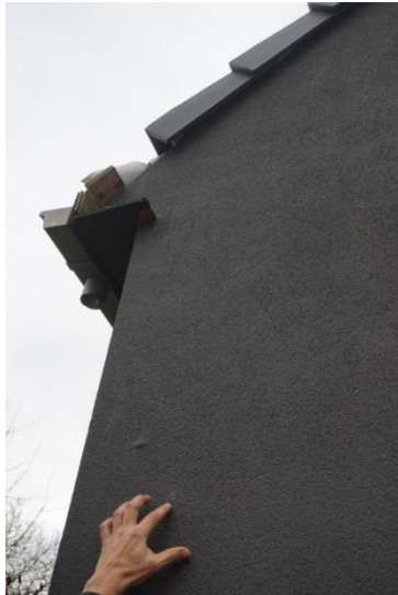
Figuur 154: Onafgewerkte dakrand
