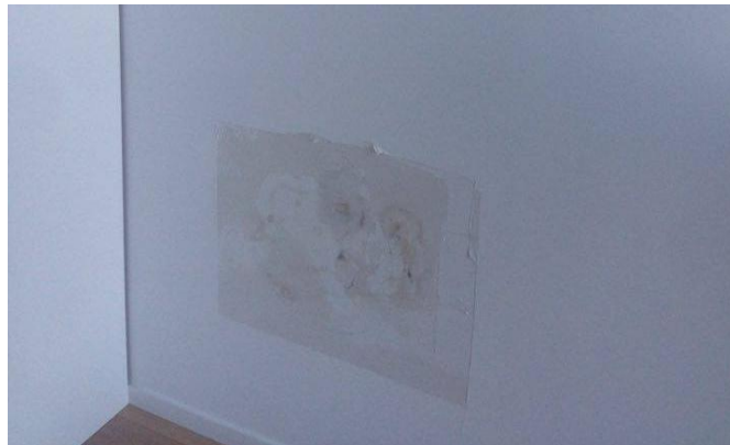
Figuur 158: Schimmelvorming aan de binnenzijde
