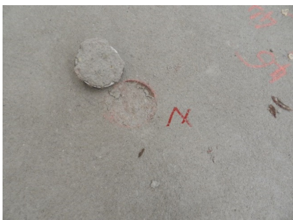
Figuur 61: Resultaat in de dekvloer na breuk
