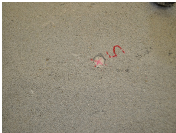
Figuur 64: Een ponsinslag in de dekvloer
