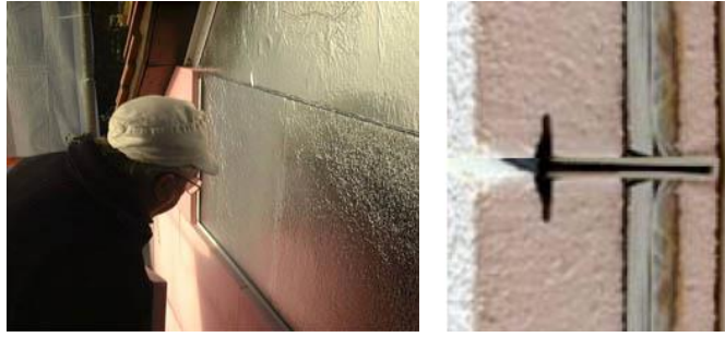
Figuur 18: Plaatsing van de gevel in Nuremberg/knoop die luchtholtes toont die een gevolg zijn van de oneffen randen van de VIP panelen. [22,45]
