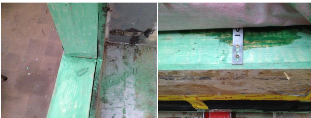
Afbeelding 61: inkrijten constructie – droge constructie - waterinfiltratie
