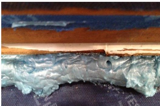
Afbeelding 152: waterinfiltratie voeg onderaan, tussen PUR-schuim en raamkader
