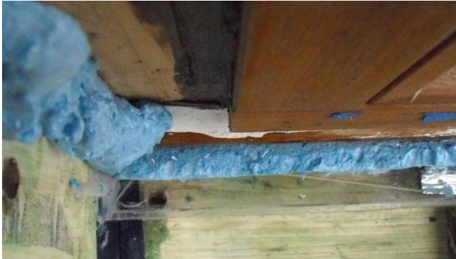
Afbeelding 149: waterinfiltratie langsheen voeg tussen PUR en raamkader
