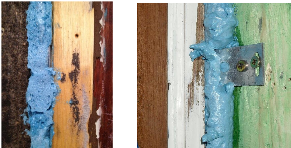
Afbeelding 150: raamanker steekt uit voorbij PUR in regenscherm, waterinfiltratie aan binnenzijde
