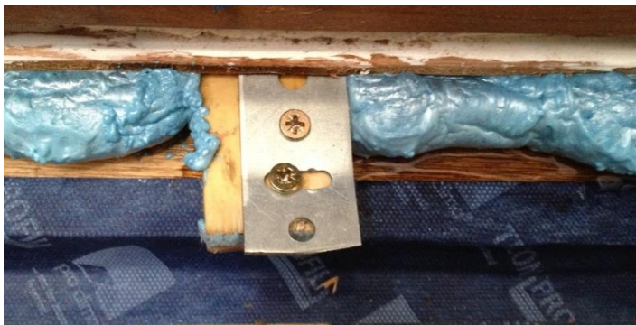
Afbeelding 151: waterinfiltratie stelblokje rechts onder
