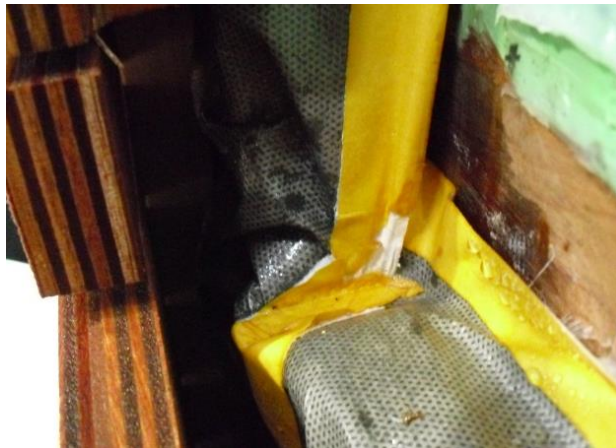
Afbeelding 117: foutieve installatie afwerkingslat
