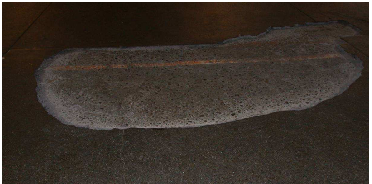
Figuur 13: Gat in de deklaag van de toegangshelling op verdiep 3 van parking 58. Het onderliggende beton is duidelijk geërodeerd.
