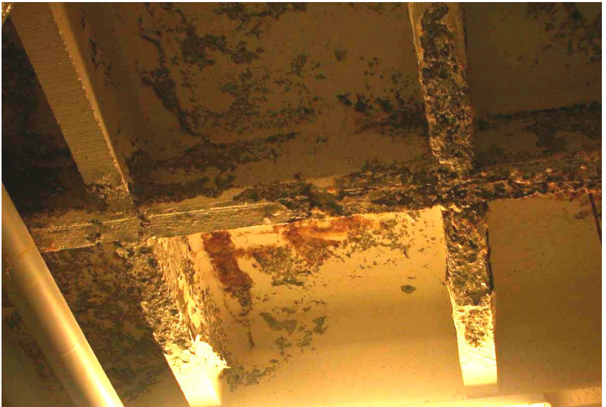
Figuur 15: Beschadiging aan de vloerplaat in de technische ruimte van ‘Les ateliers Delle’
