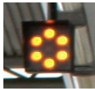
Figuur 11: Aanwijzer Verrichtingen Gedaan (AVG) in station Brussel-Zuid
