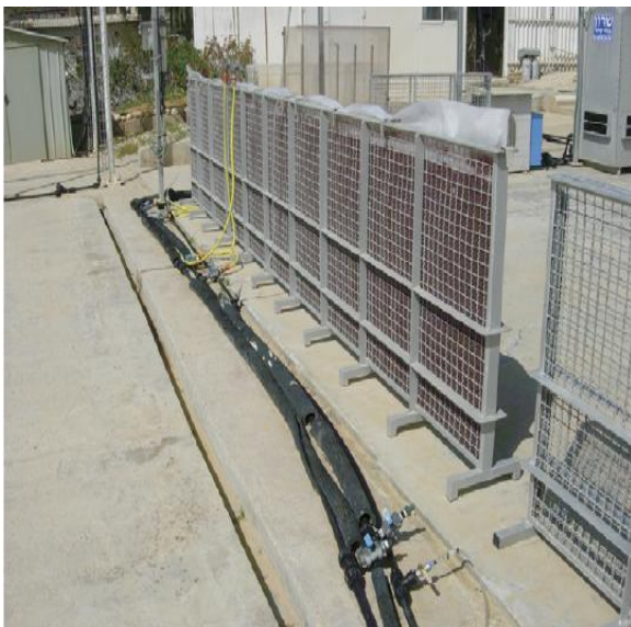
Figuur 9: Flat panel bioreactoren
