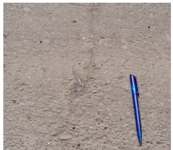
Figuur 65: De kalkuitbloeiing aan het scheuroppervlak
