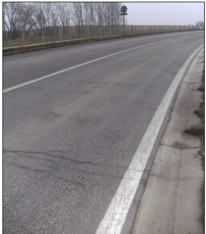
Figuur 74: De scheurvorming voor de op de rijstrook rotonde-station
