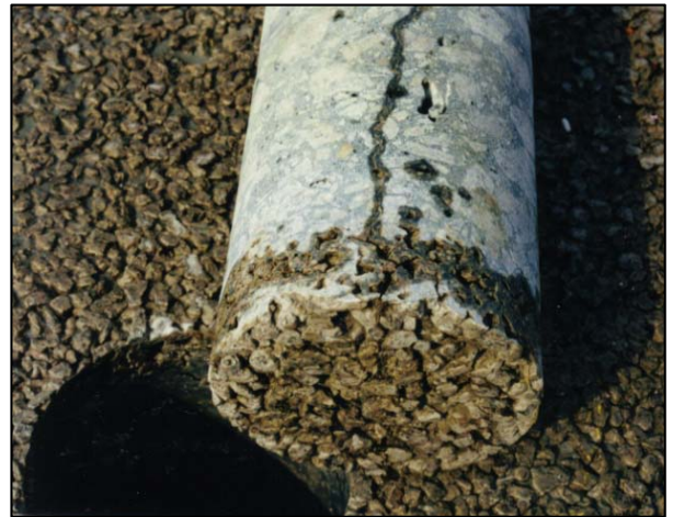
Figuur 79: Het zeer open beton
