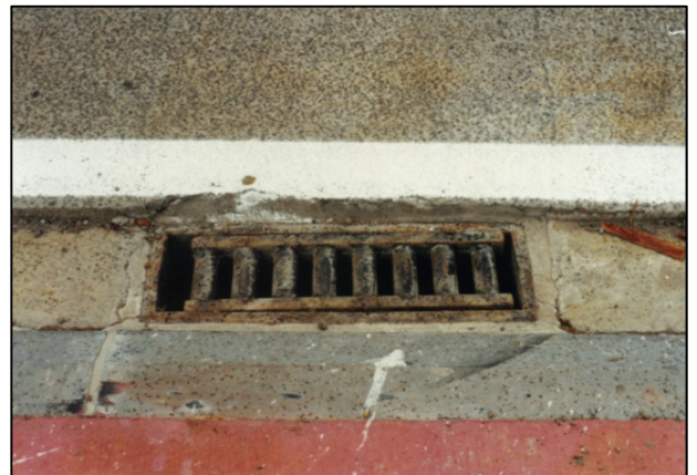
Figuur 84: De scheurvorming naar een watersliker
