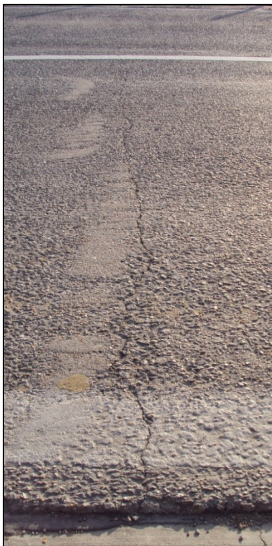
Figuur 73: Duidelijk zichtbare scheur (rijrichting weg van rotonde)
