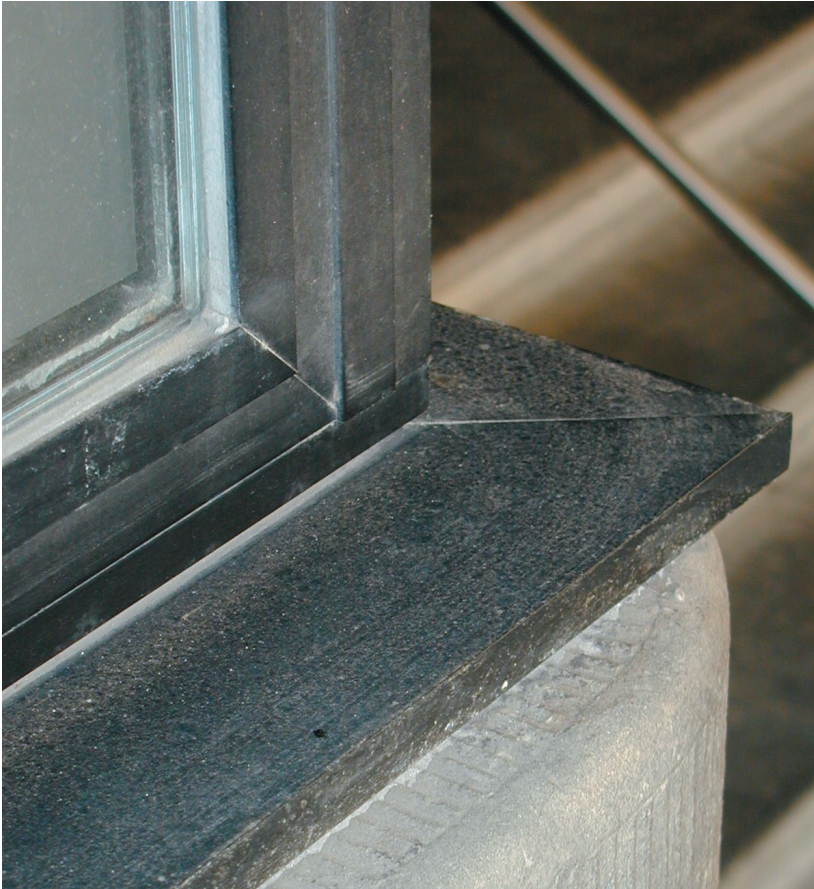
Inkom Centrale Bibliotheek: detail schrijnwerk: afgeronde hoeken van Henry van de Velde worden niet gerespecteerd
