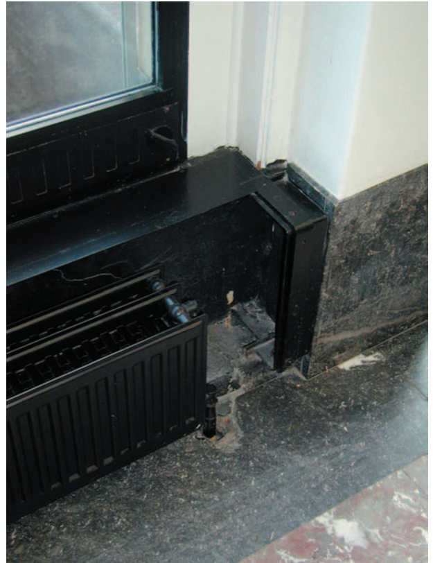
Radiator naast radiatornis, beschadigd mauer, geen stalen radiatorkap meer
