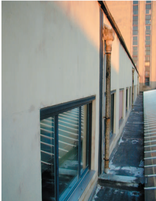
Slechte toestand dak, regenwaterafvoer, dakrand, ...
