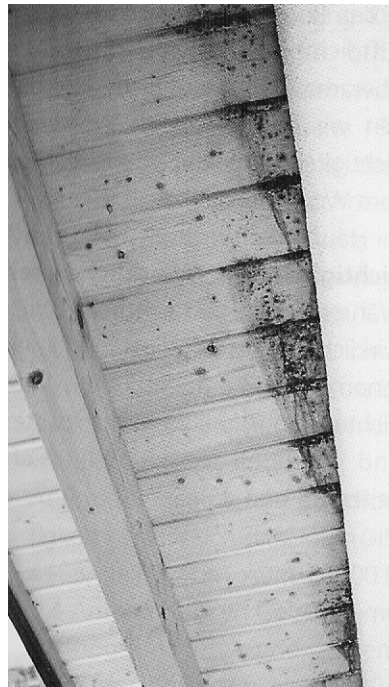
Figuur 77. “bouwschade door luchtlekkage” [10]
