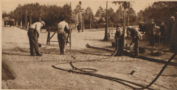
REJOINTOIEMENT DE PAVAGE A L'EMULSION « BITUMIX ». EVIDEMENT DES JOINTS A L'AIR COMPRIME.
