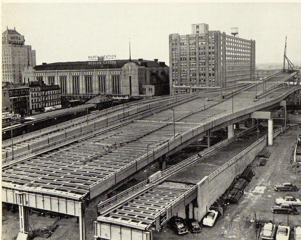
Chaussée surélevée à Boston (U. S. A.). Le viaduc portant cette chaussée a exigé la mise en œuvre de 16 000 t d'acier. Son prix s'élève à 25 millions de dollars. Constructeur : « Bethlehem Steel Company ».
