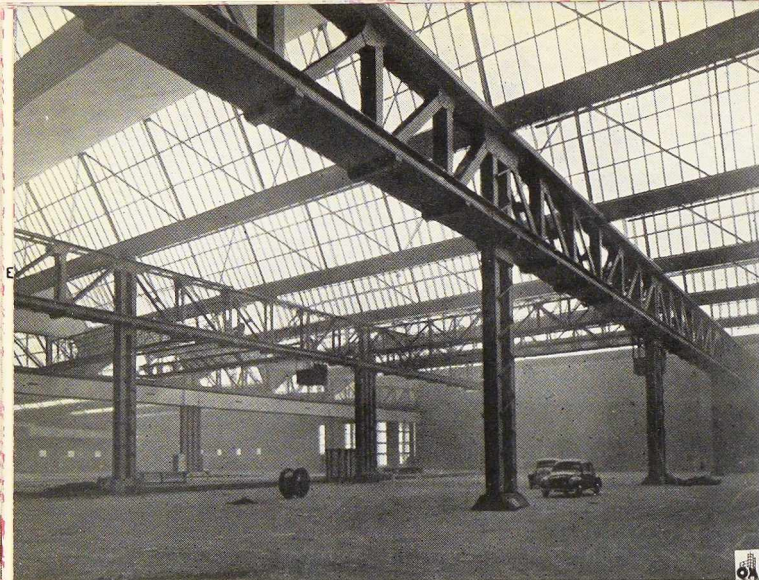
Fig. 6. Impressionnantes poutres en treillis constituant le système porteur du Palais des Expositions.
