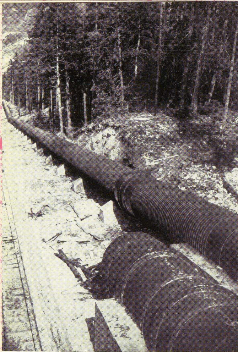
Fig. 7. Vue partielle des conduites forcées de la chute de Malgovert.
