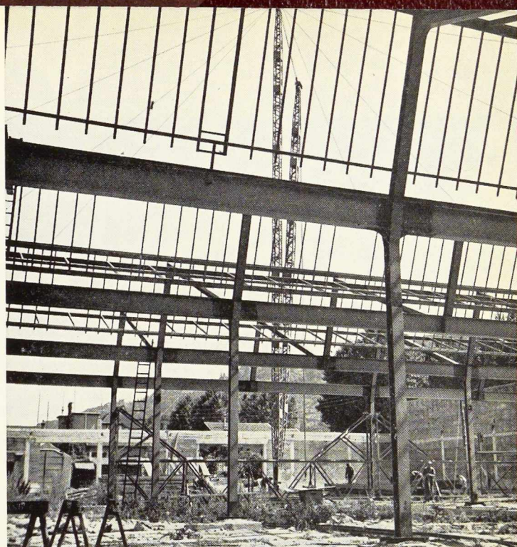
Fig. 4. Vue partielle, prise au cours des travaux, du bâtiment couvrant une superficie de 6900 m 2 destiné à abriter les ateliers et les laboratoires.
