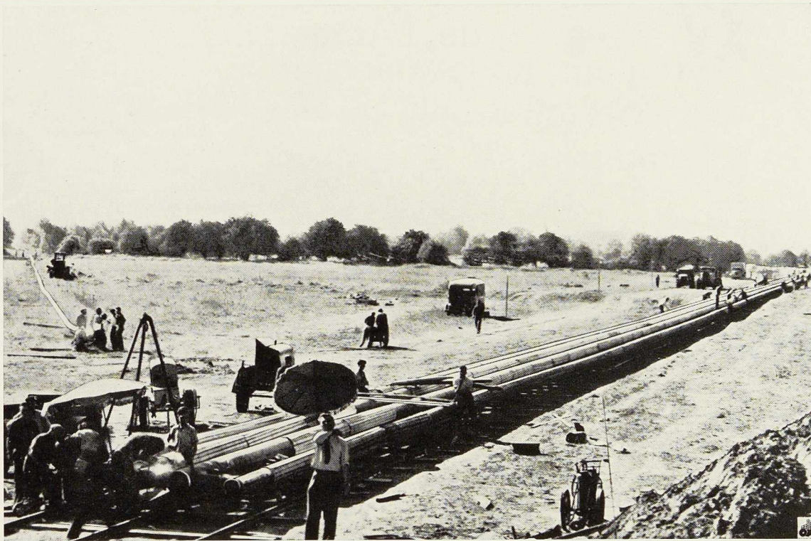
Fig. 14. Préparation des tubes sur la rive droite pour la traversée de la Seine à Aizier.
