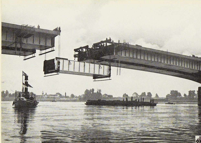
Fig. 30. Mise en place par palans du dernier élément du caisson amont. Pour réduire le poids mort, les portiques visibles à la figure 29 ont été démontés.
