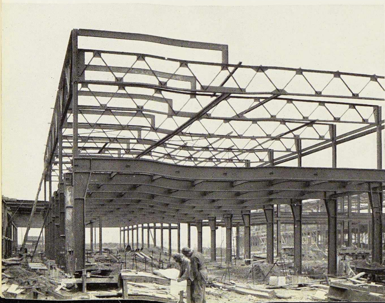
Fig. 11. Charpente métallique de la salle de conférences. Les portiques ont une portée de 18,40 m.
