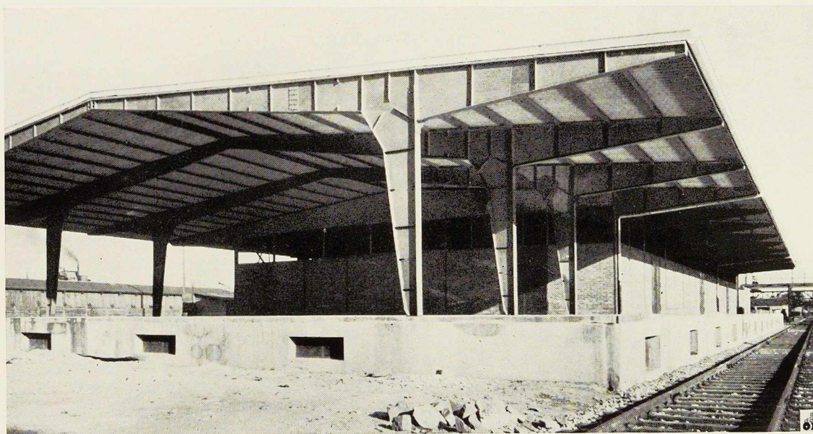
Fig. 5. Extrémité du hangar à pétrole. Au premier plan, le quai de chargement couvert. Les béquilles de la charpente métallique sont distantes de 20,24 m, tandis que l'écartement entre les portiques est de 5,25 m.
