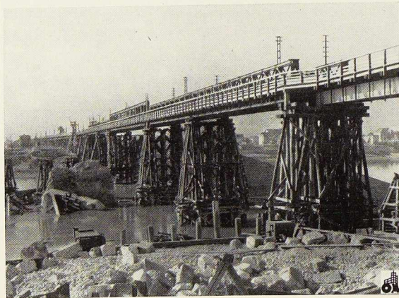
Fig. 3. Vue du pont provisoire sur la Save près de Brod; à gauche les débris de l'ancien pont.
