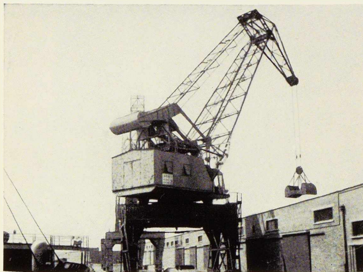
Travail en cours d'exécution au Port de Zeebrugge. Les peintures Bessemer sont employées. La finition sera en aluminium.
