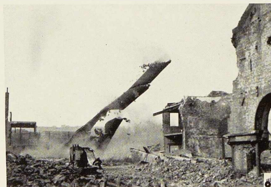
Fig. 3 (ci-dessous). Ecrroulement d'une cheminée.
