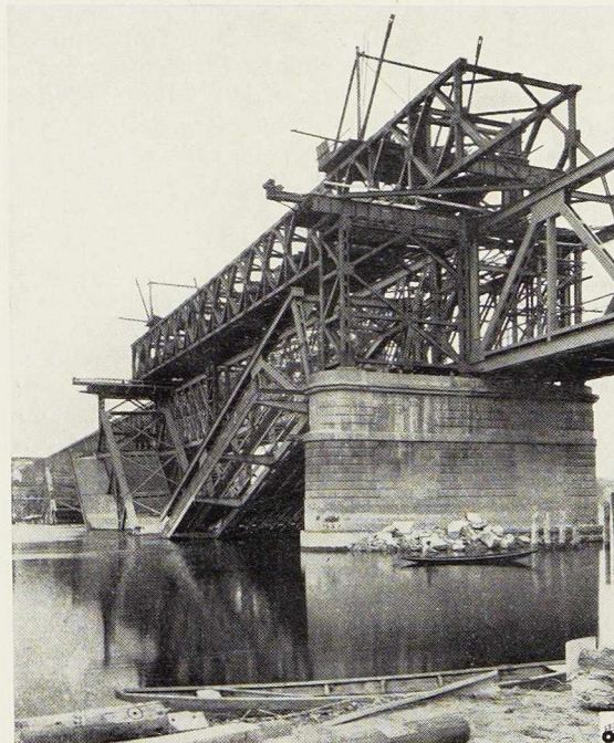
Fig. 14. Vue du pont de service en cours de ripage pour le relevage du pont-route.
