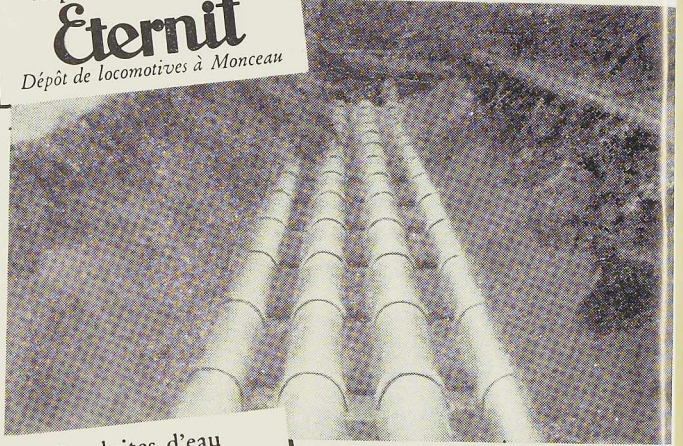
Conduites d'eau Éternit Charbonnages Limbourg-Meuse, Eysden
