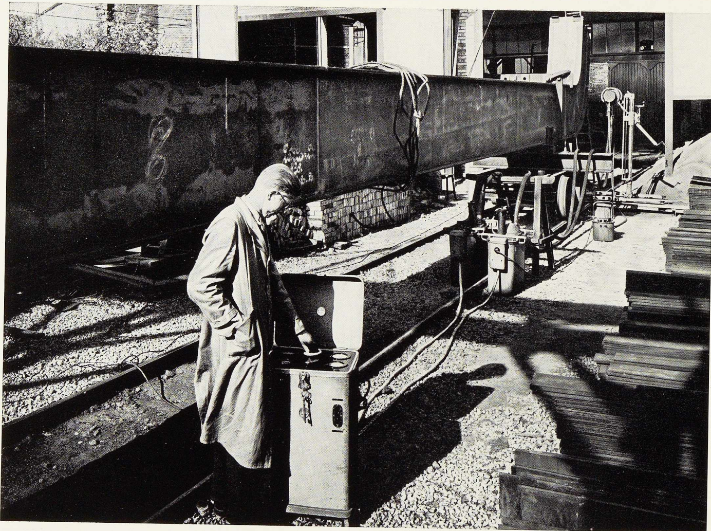
Contrôle par radiographie des joints soudés bout à bout d'une colonne en caisson
