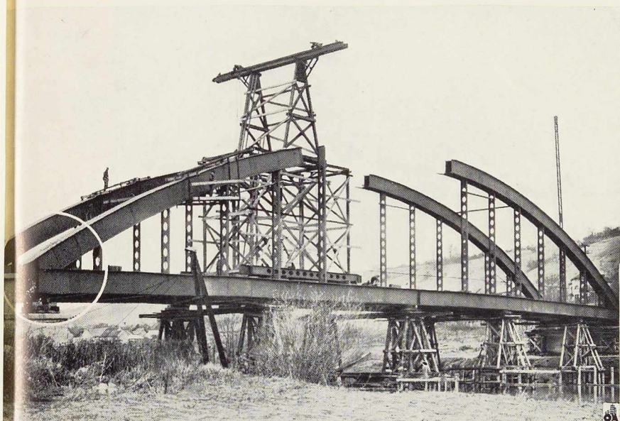
Fig. 407-408. Détail des abouts des maitresses-poutres du pont - route de Jaulgonne, montrant les joints de montage.
