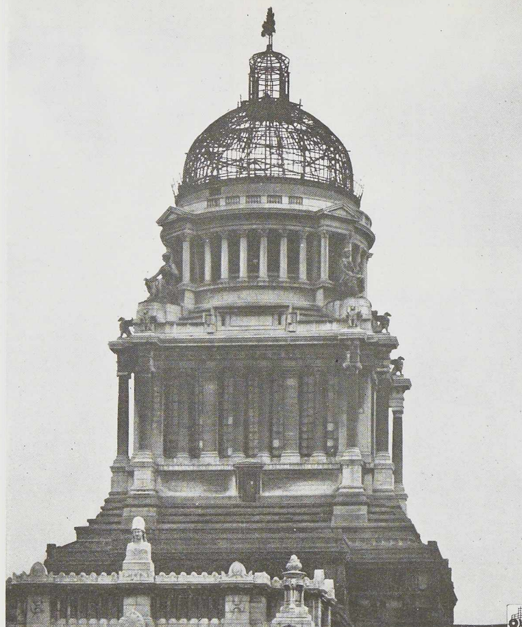
Fig. 381. Ossature du dôme surmontée d'un sapin indiquant que la hauteur définitive est atteinte.
