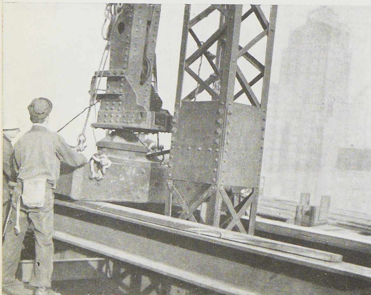
Fig. 410. Arrivé à hauteur voulue, le mât est fixé à son nouvel emplacement et solidement haubané. A son tour, il servira de point d'appui pour soulever le bras.
