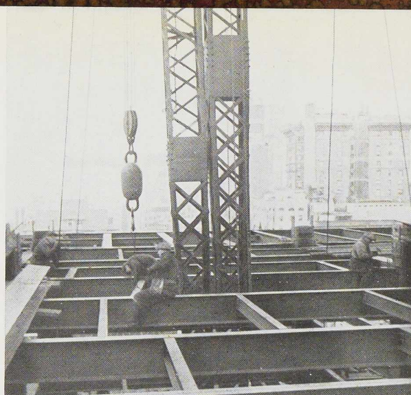
Fig. 406. Pour la continuation des travaux, il faut remonter le derrick de deux étages; dans ce but, on amène le bras contre le mât, ce qui permet de compléter la poutraison du plancher supérieur.
