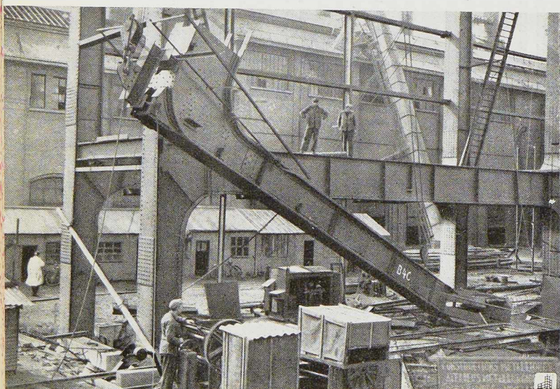
Fig. 628. Montage de l'ossature de la charpente de la nouvelle chaufferie de la centrale de Langerbrugge.
