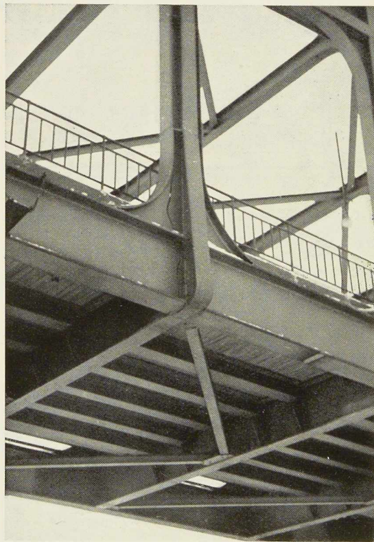
Fig. 161. Fissuration I de la poutre aval.
