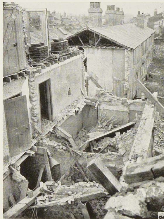
Fig. 292. Vue des maisons effondrées sur les caves renforcées par des étançonnements métalliques.
