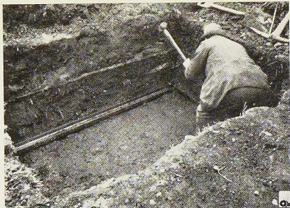
Fig. 279. Mise en place du cadre de fondation dans lequel viendront s'emboîter les panneaux en tôle.
