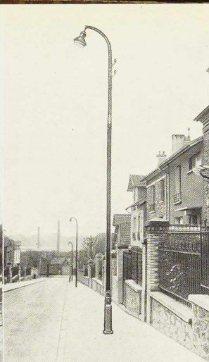
Fig. 363. Pylône en poutrelle à larges ailes comprenant deux tronçons assemblés par soudure, installé à Nogent-sur-Marne. Le tronçon supérieur est découpé et plié pour former potence.
