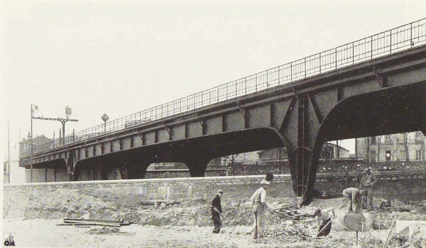
Fig. 47. Vue de l'ouvrage en cours de construction. La travée centrale se trouve au-dessus de la rampe d'accès d'un passage souterrain.
