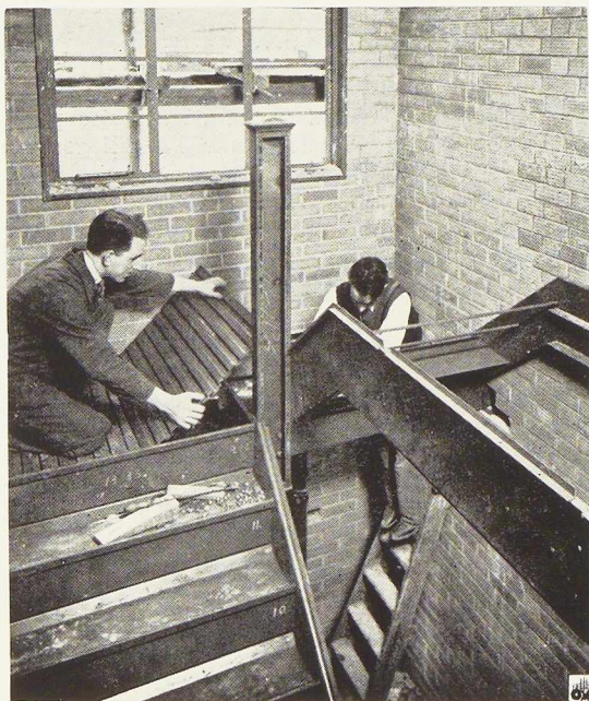
Fig. 5. Mise en place de la tôle pliée en queue d'aronde constituant la partie portante du palier intermédiaire. Les limons sont en tôle, chaque volée est construite en usine.
