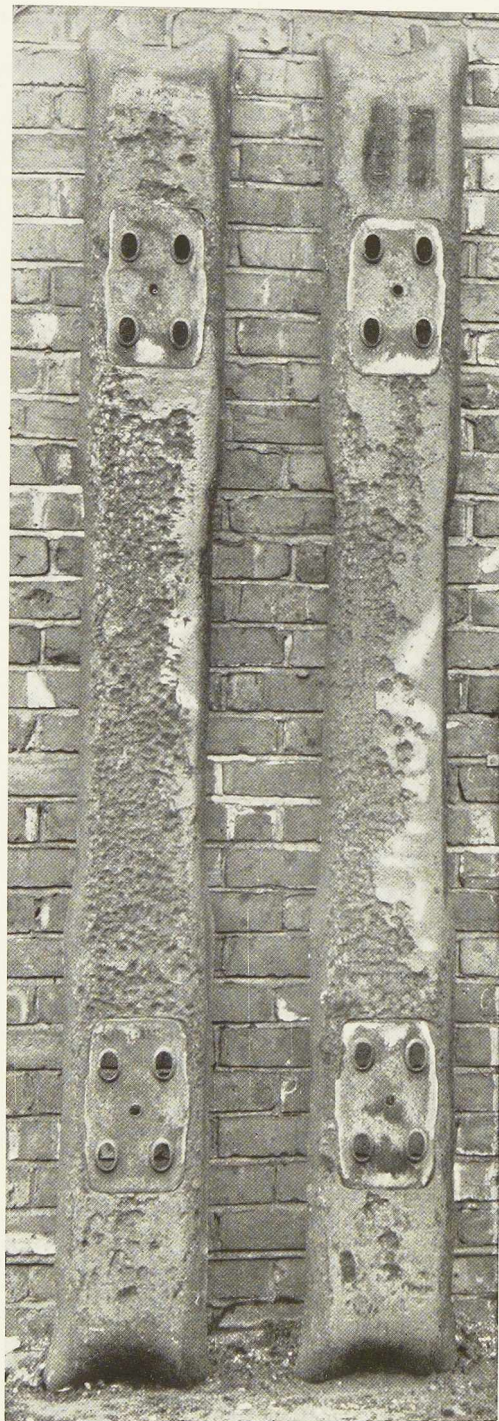
Fig. 787. Traverses de chemins de fer corrodées par suite de leur teneur trop forte en soufre.
