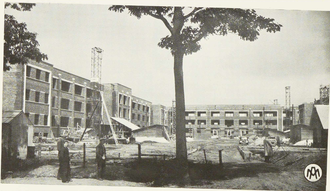
CASERNES DE TURNHOUT · 1 re entreprise : 26.000 m 2 · 2 e entreprise : 3.000 m 2 · Entreprise GARNIER, BRUXELLES
