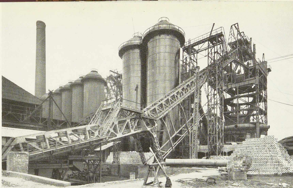
CHARPENTE DE HAUT FOURNEAU ET APPAREILS COWPER EN MONTAGE AUX USINES GUSTAVE BOËL A LA LOUVIÈRE
