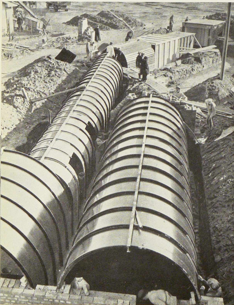
Fig. 243. Vue d'ensemble des abris anti-aériens de la foire de Leipzig. On voit les différents types constructifs adoptés.
