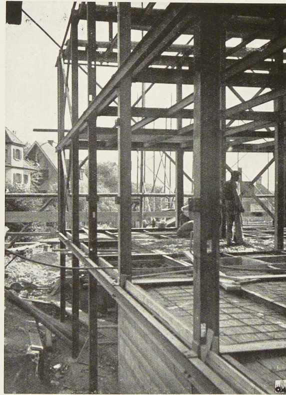
Fig. 157. Détail de l'ossature métallique : on note les poutres porte-murs, excentrées par rapport aux colonnes, et le contreventement en croix de Saint-André.
