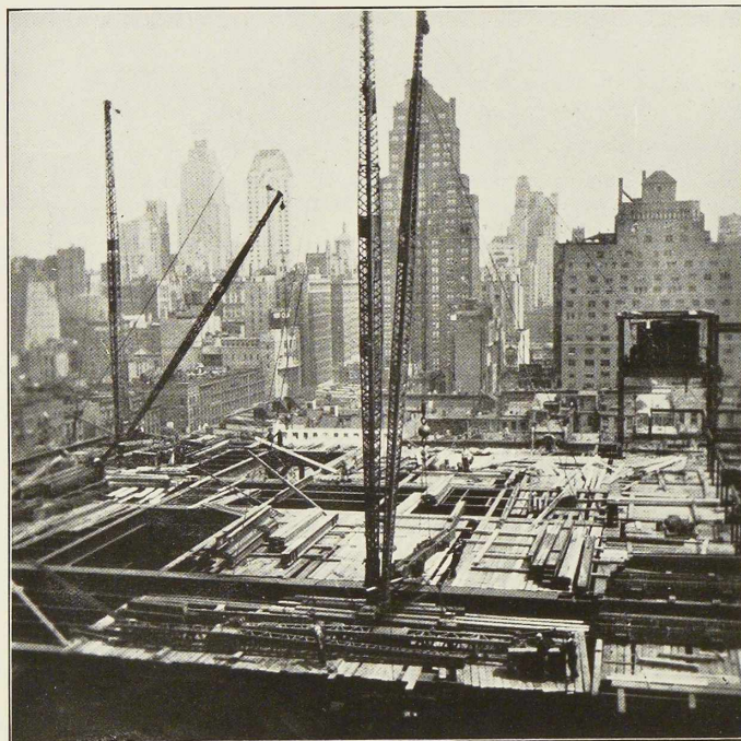
Fig. 5. Grue-derrick servant à l'érection de l'ossature métallique. Ces grues ont une capacité allant jusqu'à 50 tonnes ; la longueur de la flèche atteint jusqu'à 36 m. La dimension des tambours des câbles limite la hauteur de levage à 33 étages ; au delà de cette hauteur, on doit faire usage d'une grue-derrick de relai. A noter le plancher de travail formé de gros madriers jointifs, protégeant les ouvriers occupés aux étages inférieurs.
