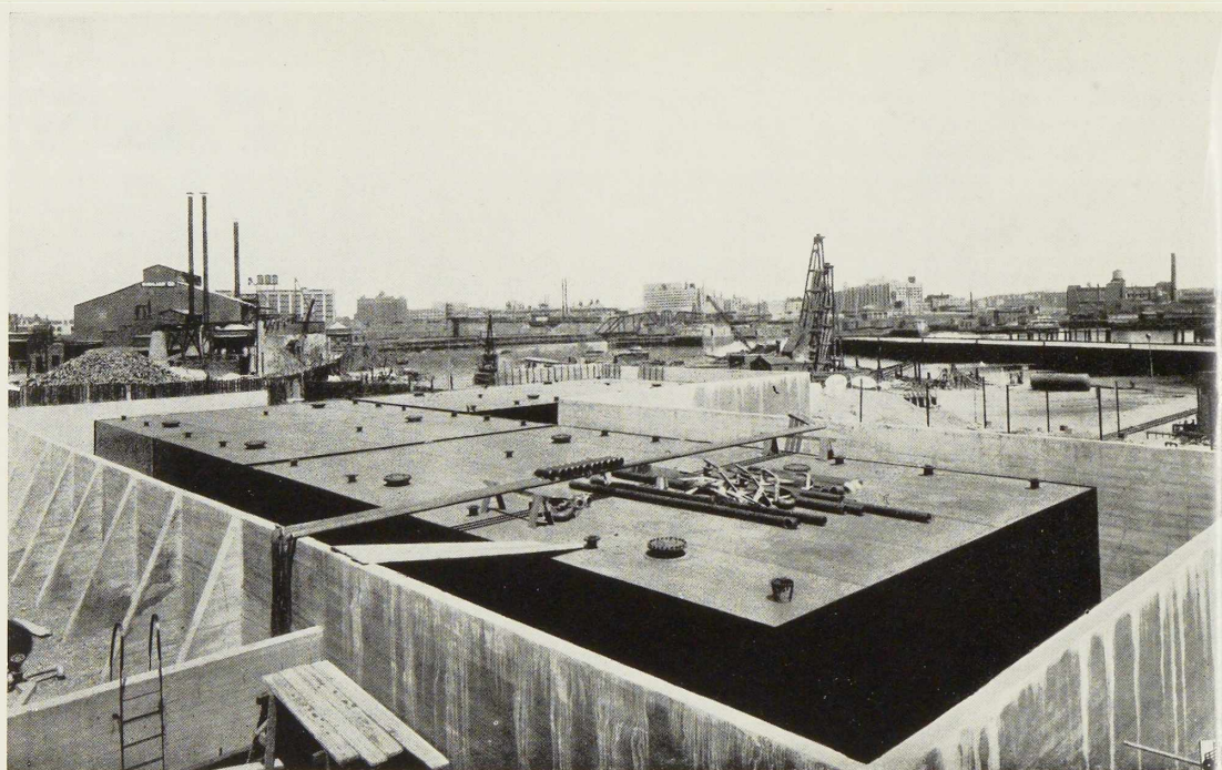
Fig. 15. Vue générale des trois réservoirs à essence dernièrement achevés à Brooklyn, N.-Y.
