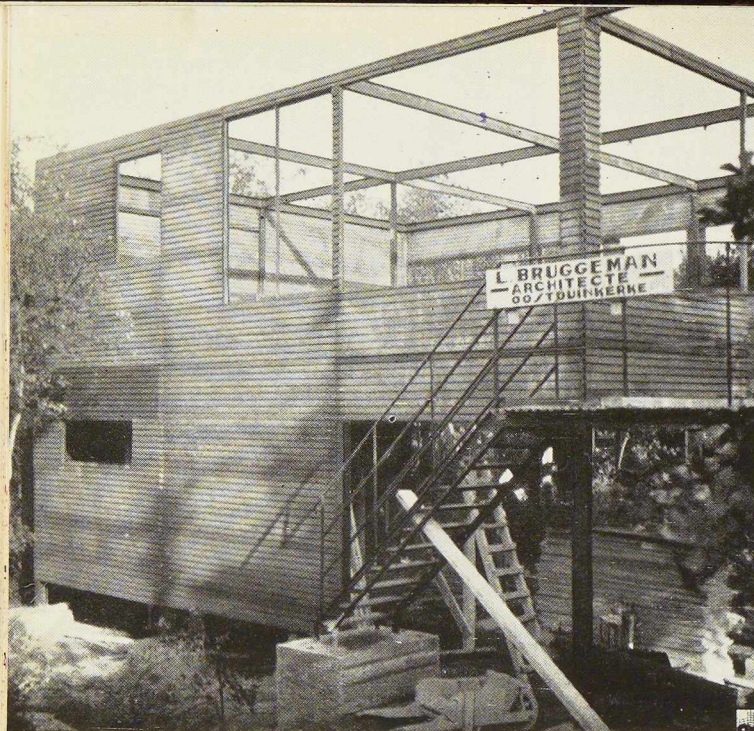
Fig. 734. L'ossature métallique est recouverte de panneaux en « Am'Acier ». Ceux-ci recevront un crépissage teinté.
