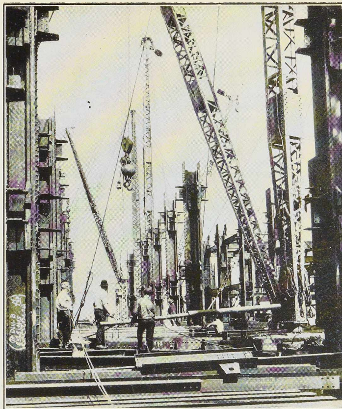
Fig. 163. Sur le plancher de travail, on effectue le triage des aciers et on les dépose dans les panneaux dans lesquels ils seront montés.
