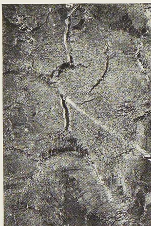
Echantillon enduit avec bonne peinture bitumineuse courante (oxydation profonde)
