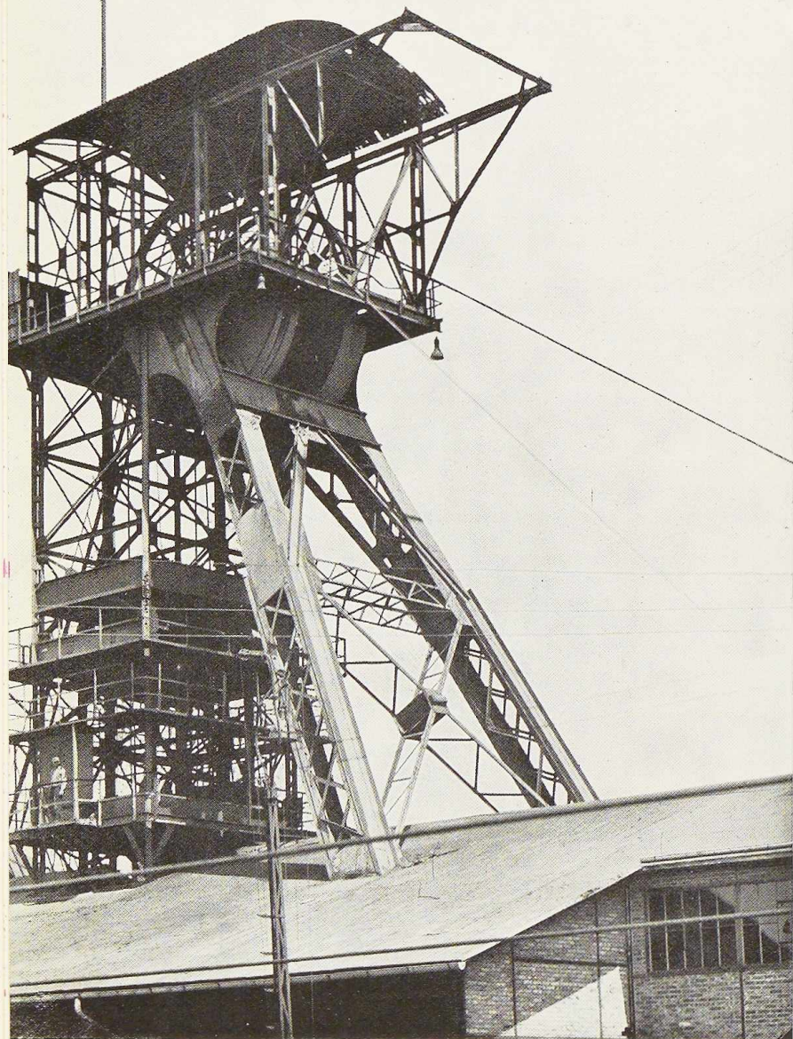
Fig. 480. Vue de la partie supérieure du chevalement renforcé. On voit notamment le renforcement des jambes de la contrefiche.
