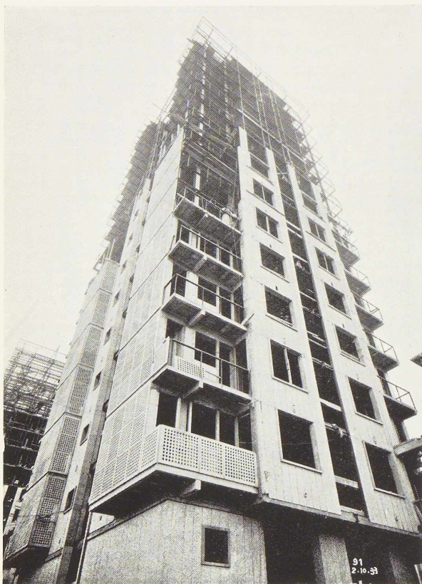
Fig. 185. Une tour en cours d'habillage. Notez le caillebotis des balcons. (Cliché Science et Industrie.)
