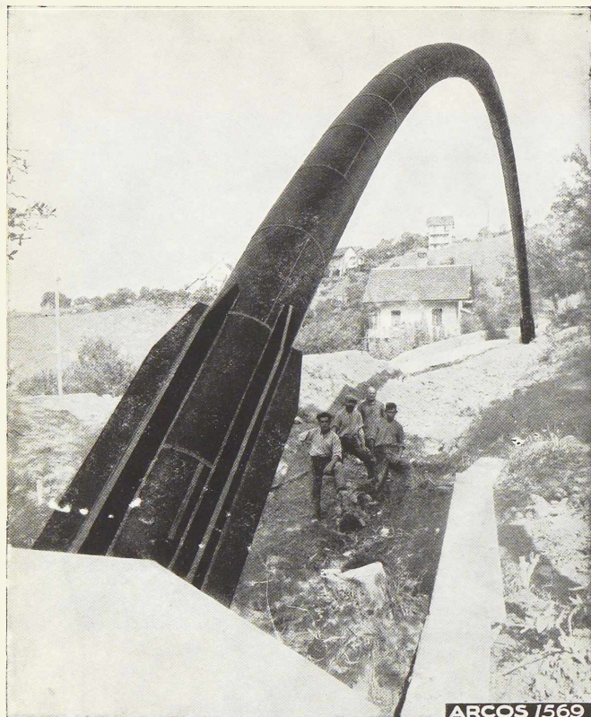
Fig. 171. Conduite métallique soudée pour l'amenée d'eau potable de la ville de Lausanne. Traversée de terrains mouvants par un tronçon en arc. (Cliché Arcos.)
