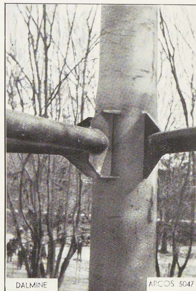
Fig. 25. Détail d'un des six nœuds d'angle d'un contreventement horizontal de la Tour Littoria à Milan. (Cliché Arcos.)
