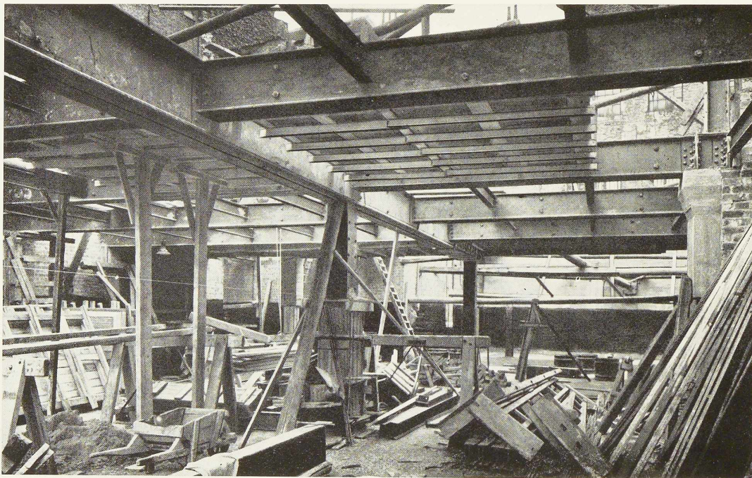
Fig. 677. Vue des sous-sols des magasins pendant la construction de la charpente métallique. On remarquera le mode de construction des hourdis en dalles en béton à l'aide de coffrages suspendus.
